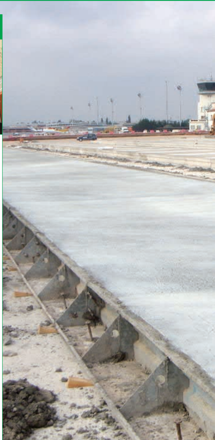
Nueva pista en el Aeropuerto de Reus (Tarragona). Producto utilizado: Mapecure E.
