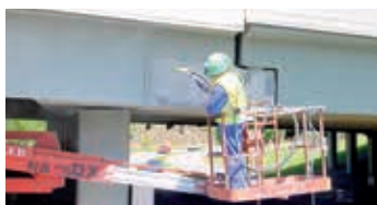
Puente Avenida del Estatut – Ronda de Dalt (Barcelona). Preparación del soporte: chorreo de arena.
