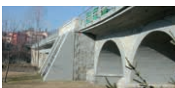
Puente en Masies de Voltregà (Barcelona). Productos utilizados: Mapegrout T40, Elastocolor Pittura.
